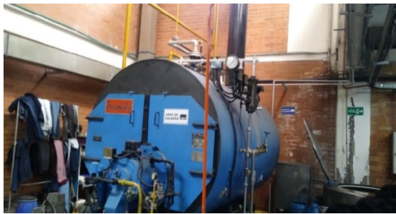
FOTO N. 4 CALDERA DE 100 BHP
